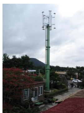
Rys1. Turbina wiatrowa 3kW.
