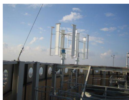
Rys3. Turbina wiatrowa 1kW.
